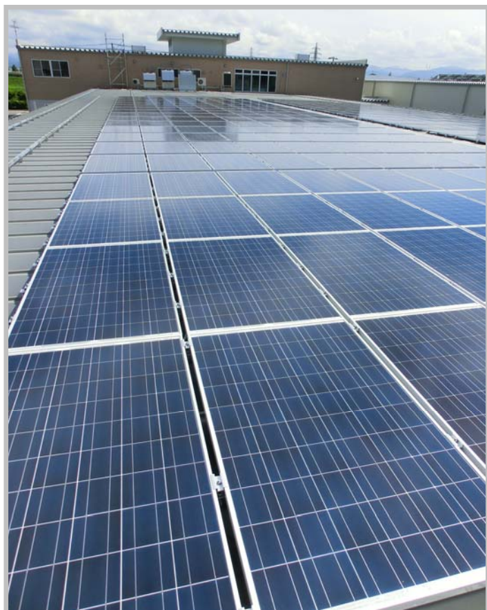
プラットホーム屋根の太陽光パネル
